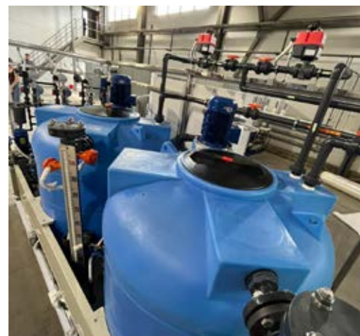
Установка приготовления и дозирования коагулянта АО «СИБЭКО» Барабинская ТЭЦ
