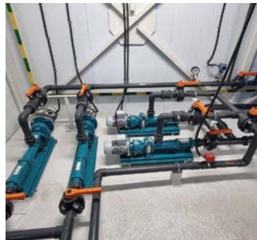
Станция очистки производственно-дождевых стоков ООО «Нефтяная компания Новый Поток»
