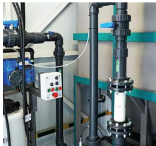
Станция очистки производственно-дождевых стоков ООО «РН-Сахалинморнефтегаз»
